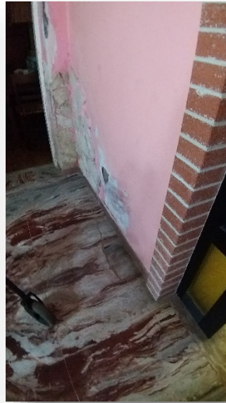
Foto 102 – Umidità di risalita
