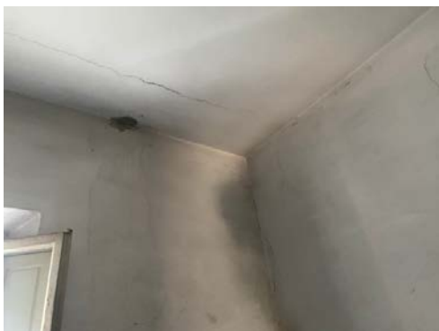
Figura 5: particolare angolo vano sottostante al bagno
