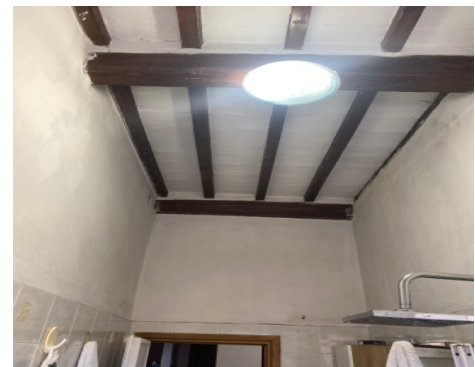
Figura 9: Travi di legno nel bagno lato porta interna
