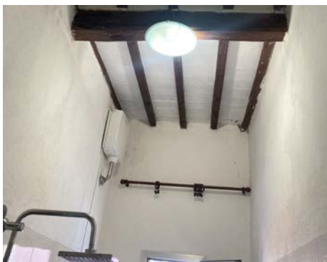
Figura 8: Travi di legno nel bagno lato finestra
