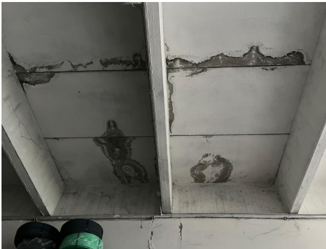
Figura 6 – DANNI DA INFILTRAZIONI
