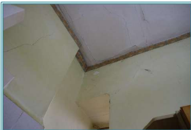
Figura 28 Dettaglio dello stato di conservazione delle pareti e del controsoffitto in tela della camera2
