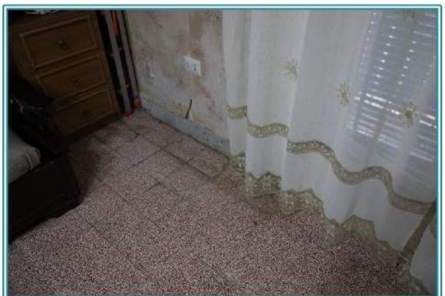
Figura 35 Segni di ammaloramento sulla parete esterna e un leggero abbassamento del pavimento nel Salone
