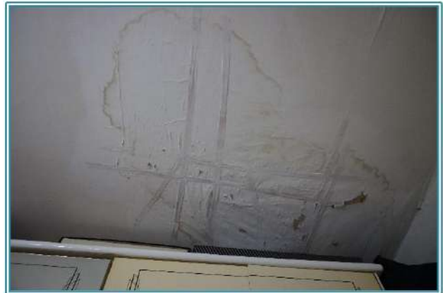
Figura 33 Evidenti segni di ammaloramento sul controsoffitto della camera1
