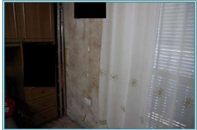
Figura 37 Ammaloramento della carta da parati presente sulla parete del salone che affaccia su Via Prima Licerta
