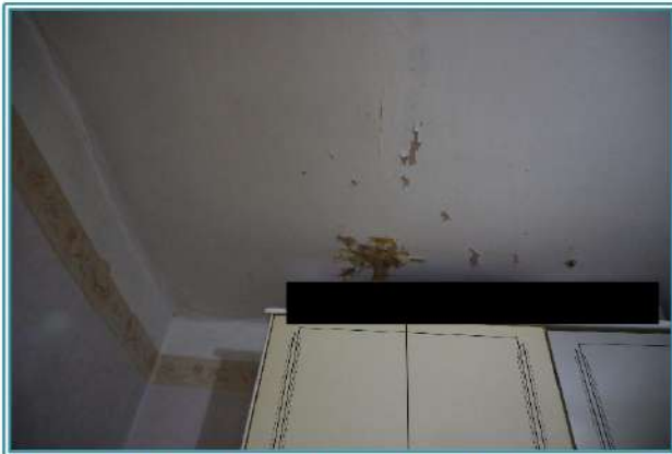
Figura 32 Segni di ammaloramento sul controsoffitto della camera1
