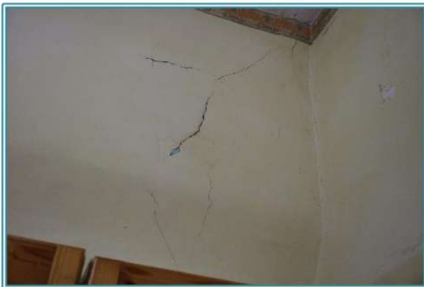
Figura 26 Crepe sull'intonaco nella camera2
