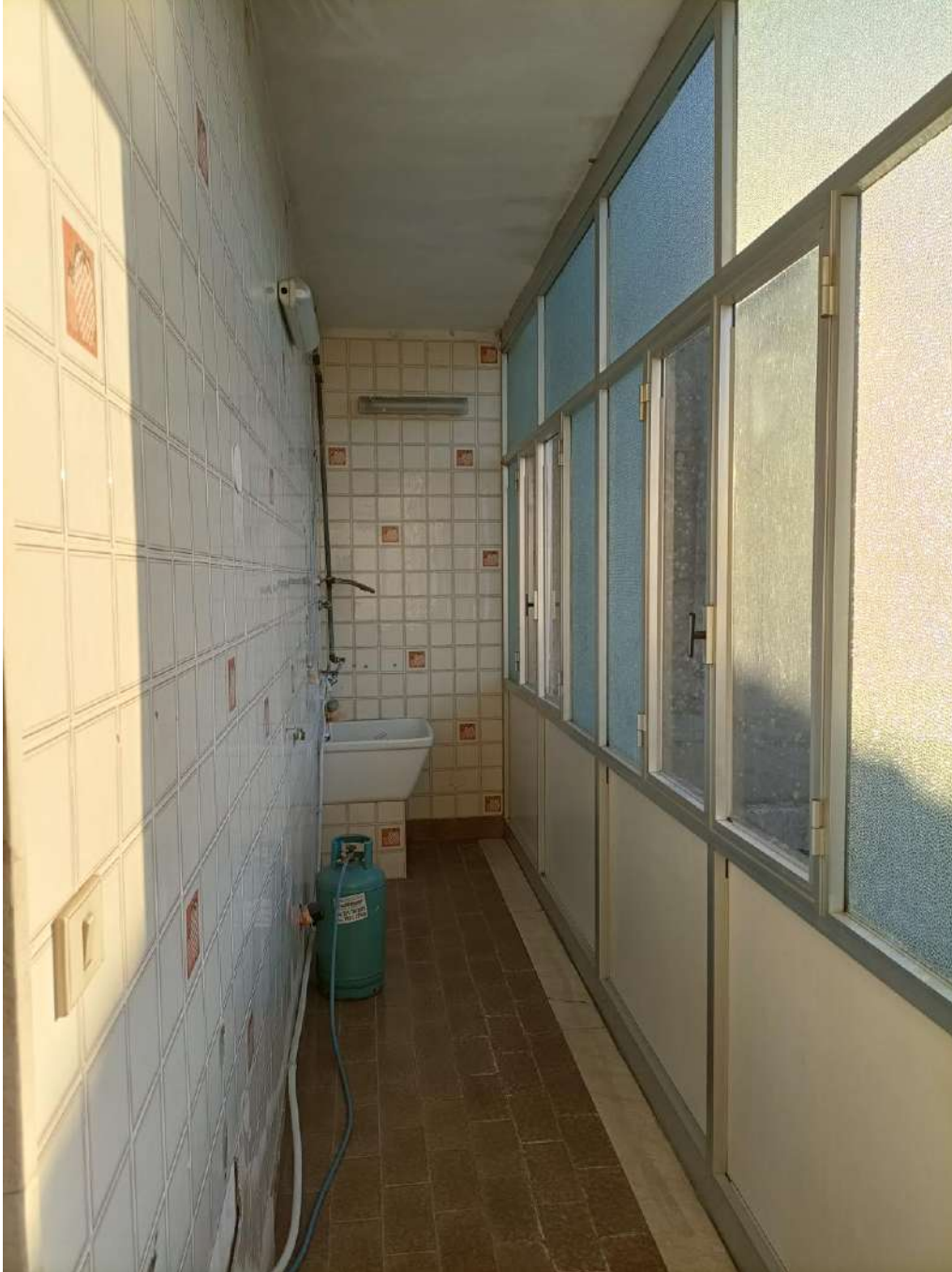
Foto 7. Vista esterna della chiusura del balcone con struttura precaria.
