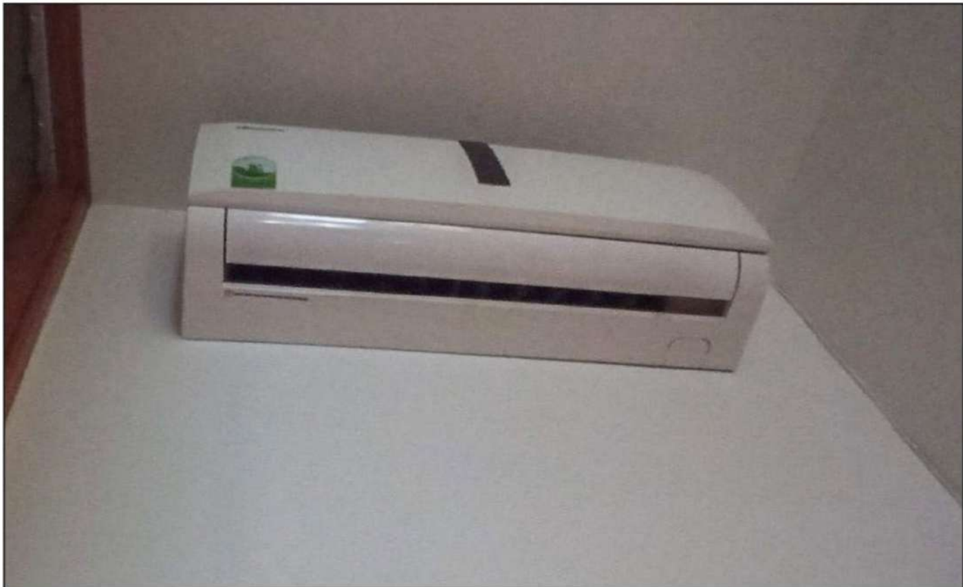
Foto 39 : impianto termico - climatizzatore
