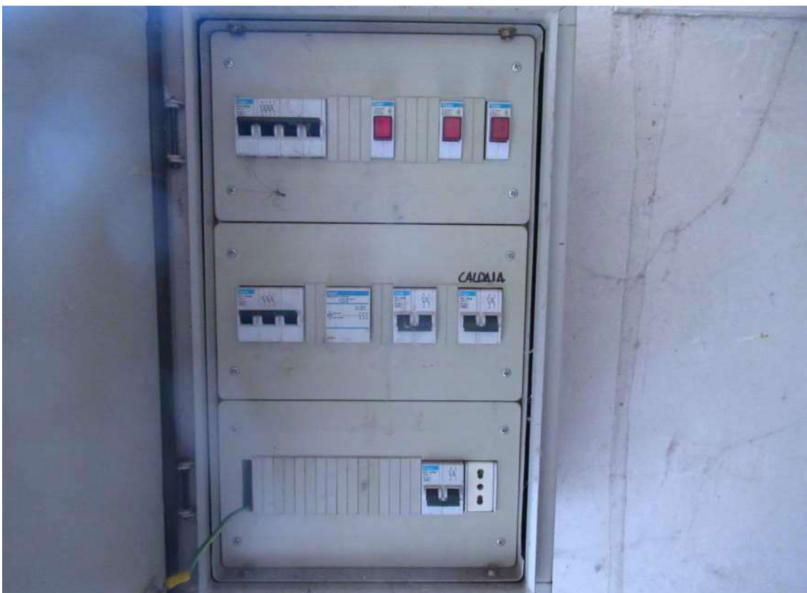
Foto 9: Quadro elettrico nel vano Centrale termica
