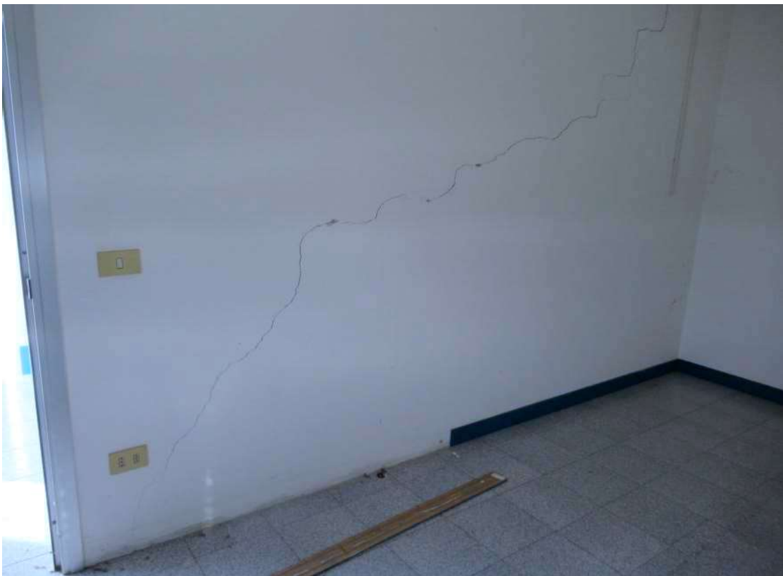
Foto 9: Parete archivio con fessurazioni
