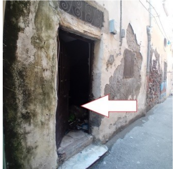
Figura 4 deposito al piano terra al civico n.18 di via Rosselli in Torre Annunziata
