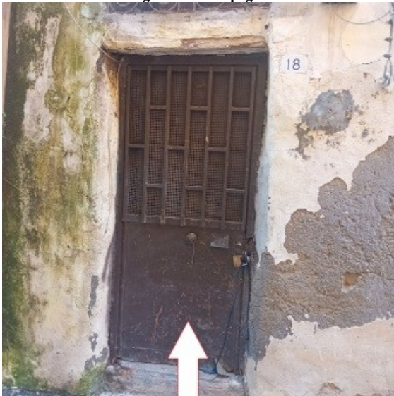
Figura 14 accesso al deposito al piano terra al civico n.18 di via Rosselli in Torre Annunziata
