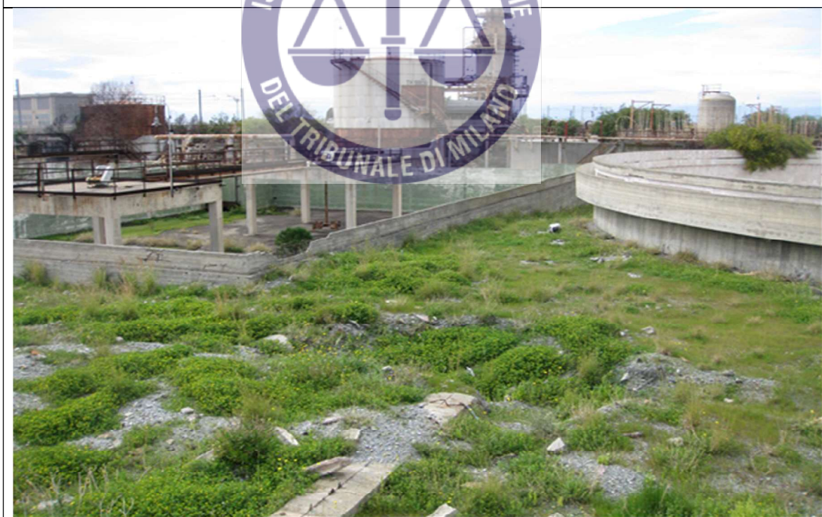
Foto n. 10 – Particella n. 238 della superficie di mq. 19.868, interamente occupata da manufatti oramai fatiscanti rappresentati da vasche in cemento armato di forma circolare e rettangolare, silos, serbatoi in acciaio, tubazioni e valvolami. Si rileva inoltre cospicua vegetazione erbacea infestante.
