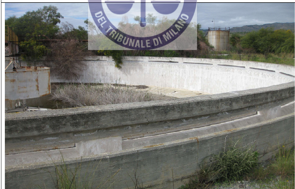
Foto n. 8 – Particella n. 238 della superficie di mq. 19.868, interamente occupate da manufatti oramai fatiscenti tra cui vasche in cemento armato di forma circolare, silos, serbatoi, ecc.
