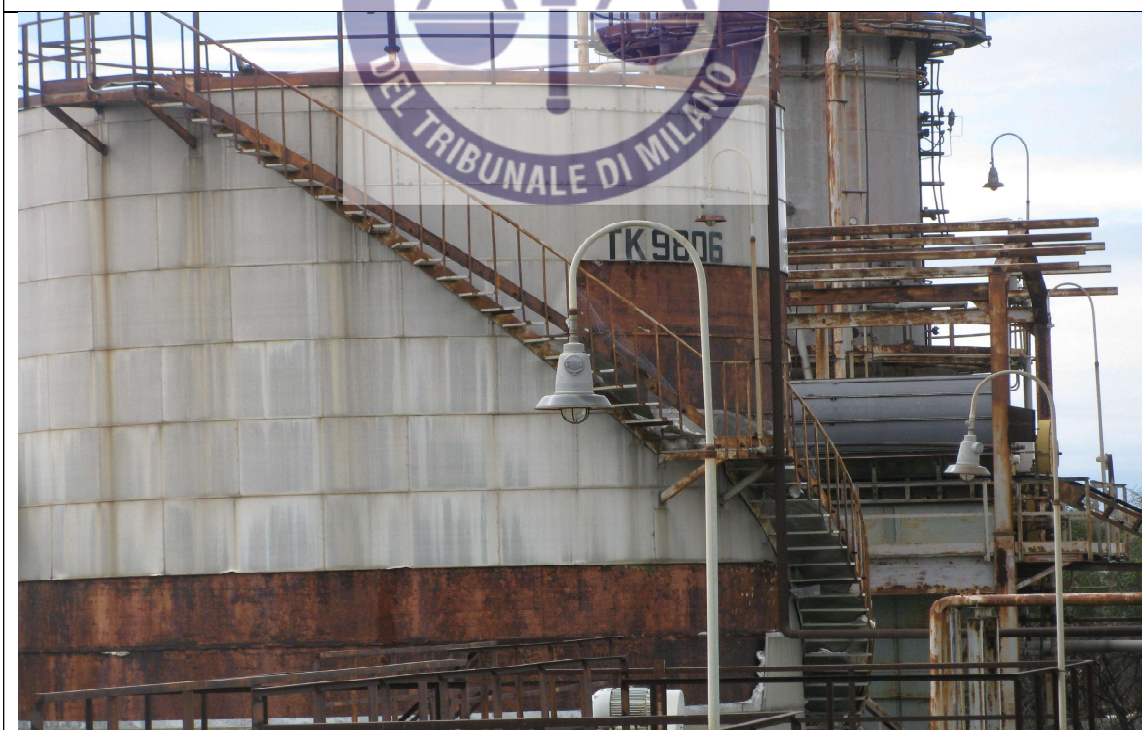
Foto n. 12 – Particella n. 238 della superficie di mq. 19.868, interamente occupate da manufatti oramai fatiscenti del vecchio impianto di liquichimica. Serbatoio di forma circolare con annesse tubazioni e valvolami.
