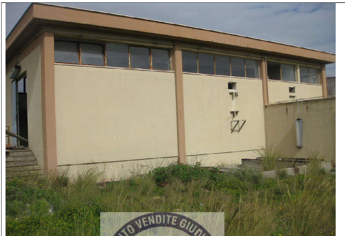
Foto n. 7 – Fabbricato con struttura portante in cemento armato ad un solo piano fuori terra posizionato nella particella n. 238, quest'ultima interamente occupata da manufatti oramai fatiscenti degli impianti della liquichimica.
