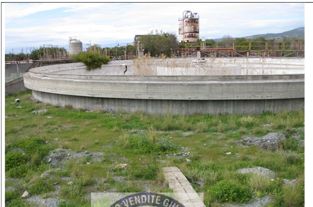
Foto n. 9 – Particella n. 238 della superficie di mq. 19.868, interamente occupata da manufatti oramai fatiscanti rappresentati da vasche in cemento armato di forma circolare, silos, serbatoi, ecc.
