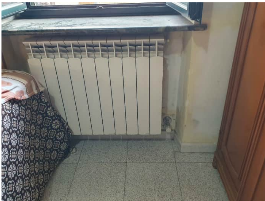
Foto 11: Particolare della stanza da letto con evidenti segni di ammaloramenti del soffitto e presenza di condensa e muffe
