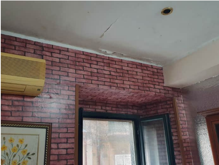
Foto 4: Finestra posta in prossimità dell'angolo cottura ed evidenti segni di ammaloramento del soffitto
