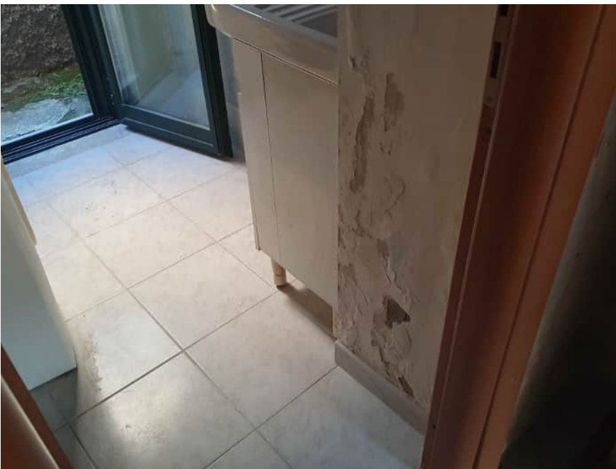
Foto 14: Lavanderia con evidenti segni di ammaloramenti delle pareti
