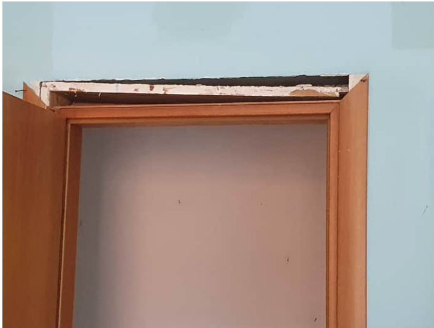
Foto 9: Presenza di controtelaio della porta della stanza da letto danneggiata
