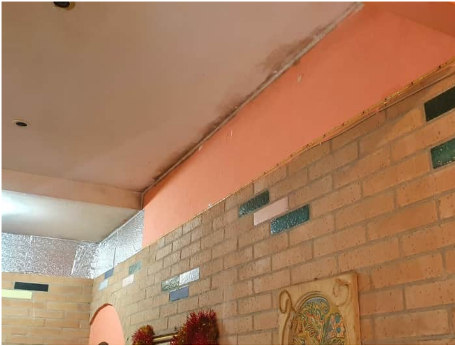
Foto 3: Soggiorno con evidenti ammaloramenti del soffitto e presenza di condensa e muffe
