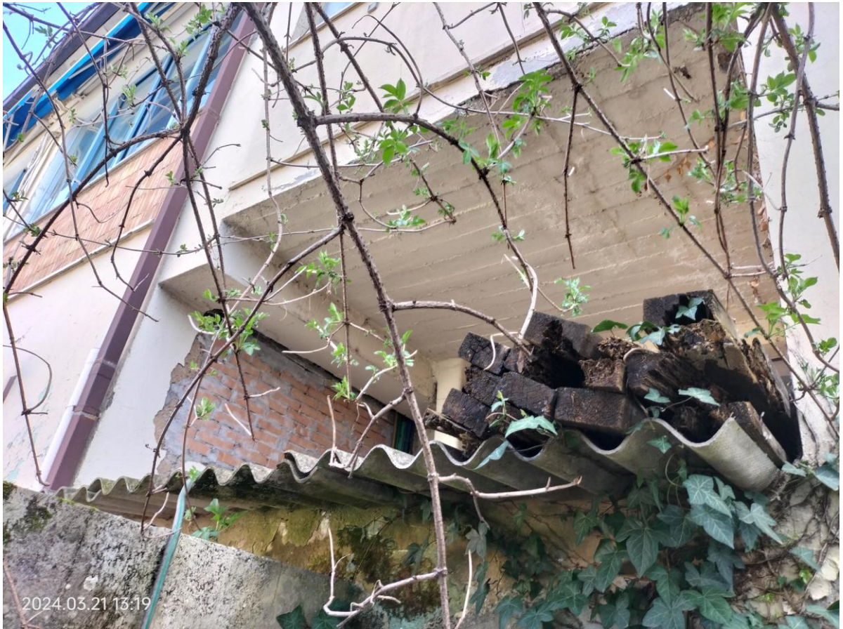
porzione di copertura della cantina (in eternit) sottostante al terrazzo del piano primo
