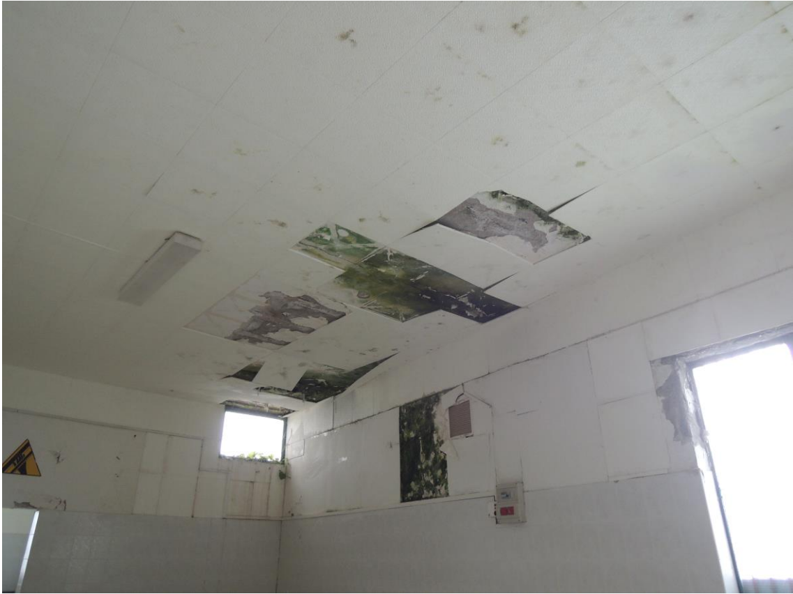
Figura 2 _particolare infiltrazione locale piano terra
