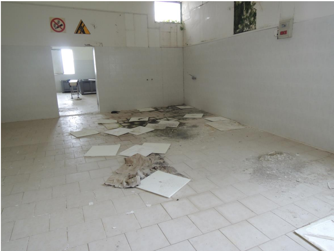
Figura 3 _particolare distacco e crollo di parte della controsoffittatura
