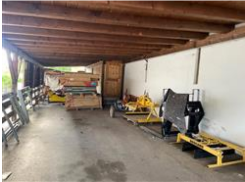
Tettoia esterna a sud (non autorizzata)
