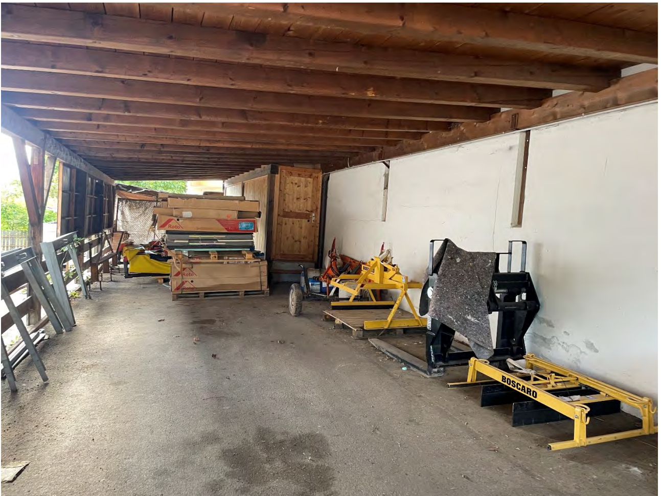
tettoia non autorizzata
