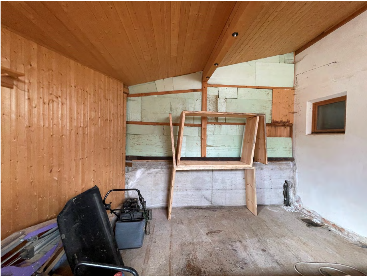
Vano esterno non autorizzato
