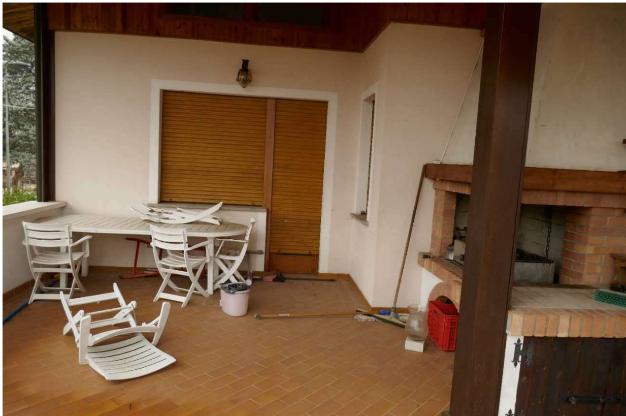
Parte sud-ovest con il caminetto esterno. Si noti il tamponamento con le tapparelle in plastica anziché con gli scuretti sul fronte est e la porta-finestra del soggiorno che è orientata a sud.
