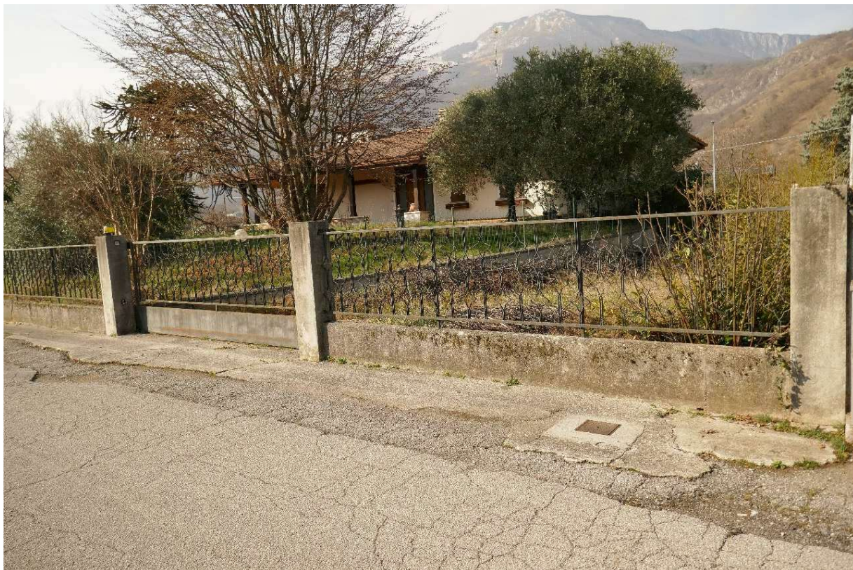
Parte a nord con ingresso carraio e portone scorrevole, in ferro, parzialmente arrugginito e bisognoso di manutenzione. L'interno presenta erba alta che occulta in buona parte le plotte in cemento che costituiscono la stradina carrabile fino al garage nel seminterrato.
