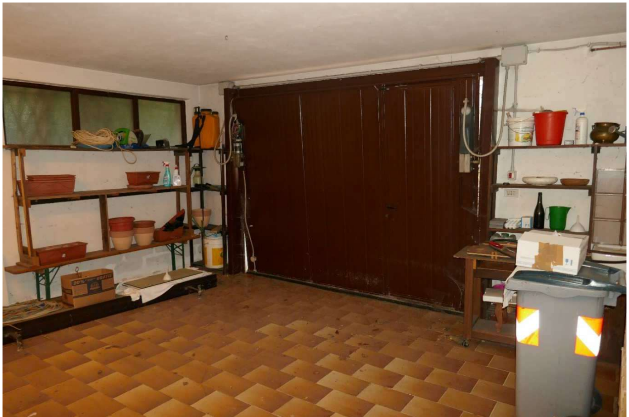
Come si può notare il portone basculante motorizzato non è perfettamente chiuso e quindi abbisogna di manutenzione.
