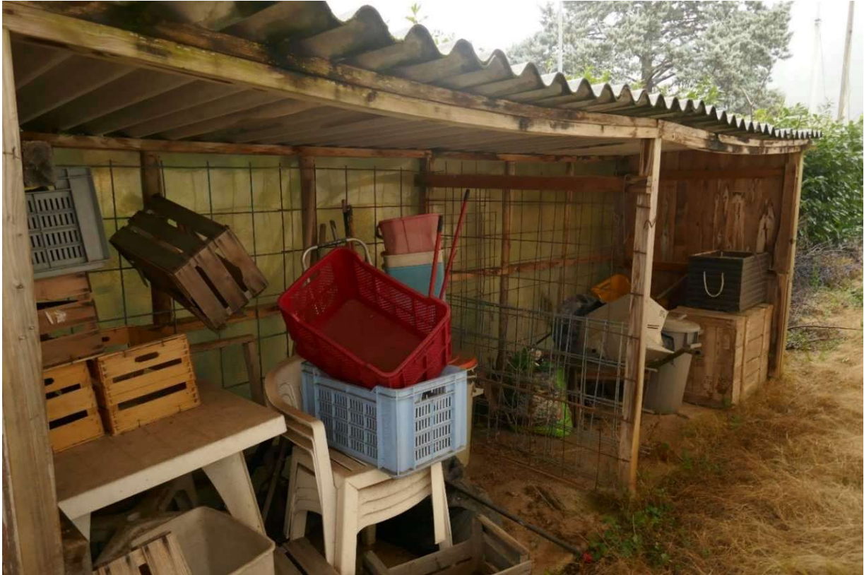
Particolare della tettoia abusiva.
