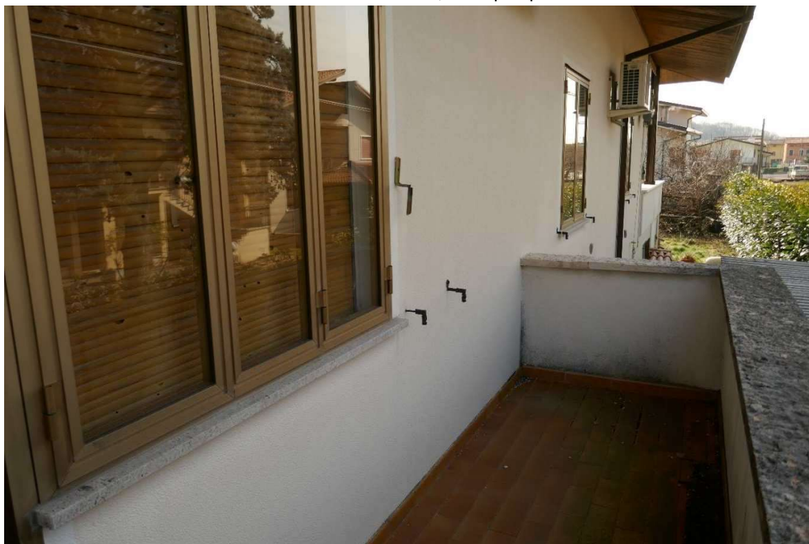
Terrazzino accessibile dalla camera matrimoniale più grande. Si possono notare le doppie finestre, con struttura in alluminio, su tutto il fronte ovest. La tapparella in plastica presenta fori da grandine.
