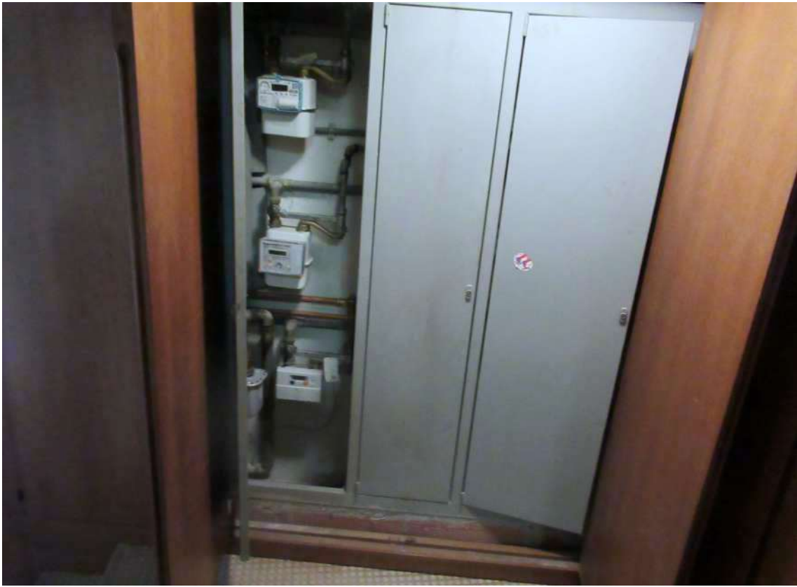
Foto 5: Contatori gas atrio piano terra
