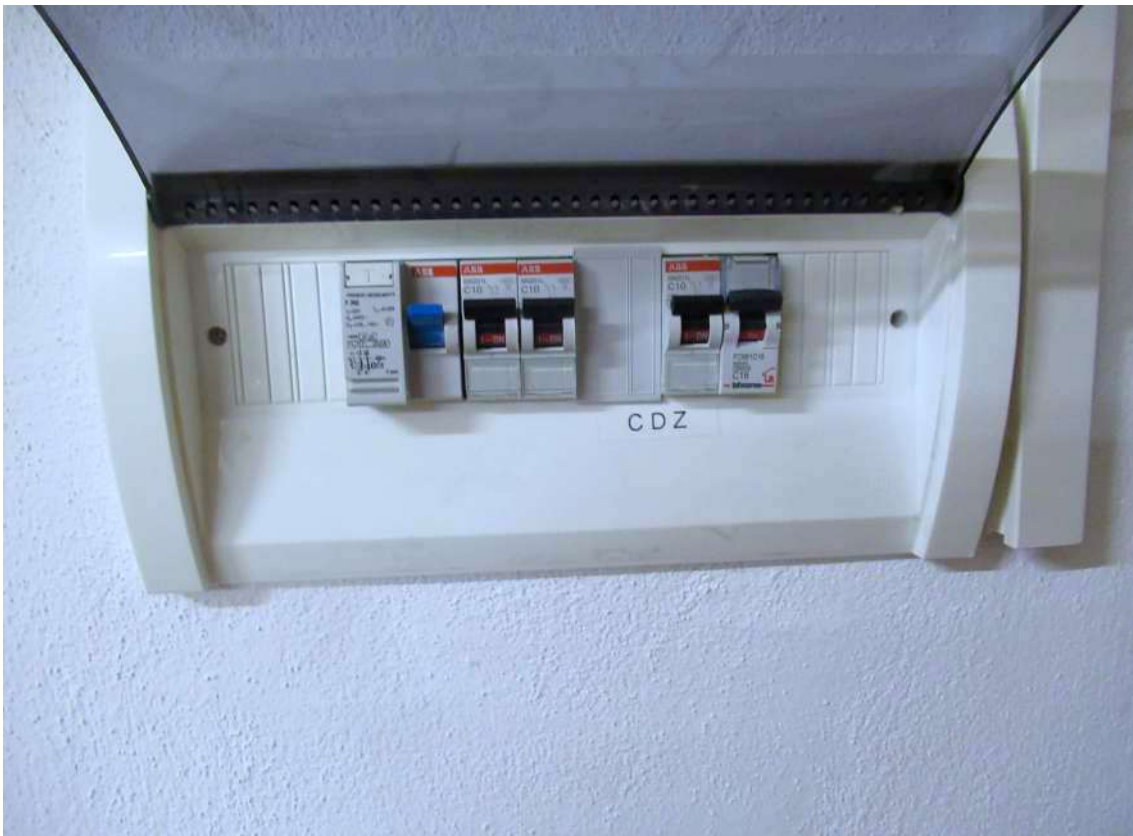
Foto 7: Quadro elettrico in ingresso
