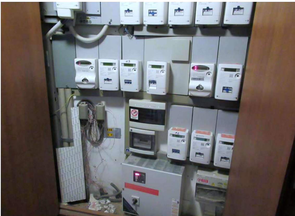
Foto 4: Contatori energia elettrica atrio piano terra
