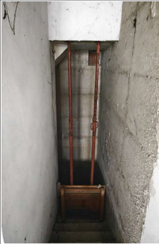
La scala di comunicazione tra box auto e locale sgombero con i puntelli
