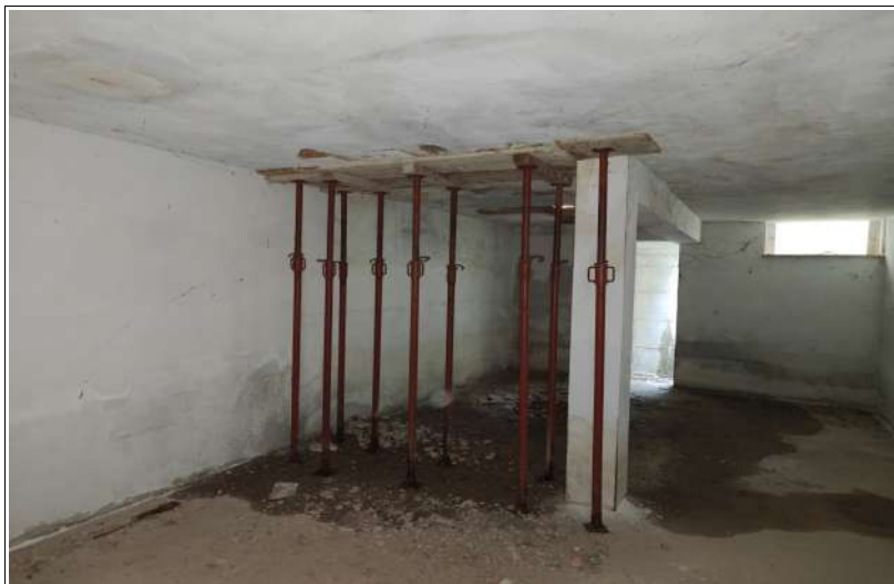
Il locale sgombero con il puntellamento dove si è danneggiato il solaio
