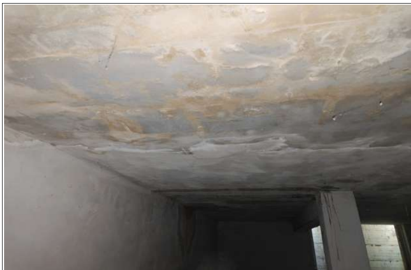
Tracce di infiltrazioni dal solaio del locale sgombero
