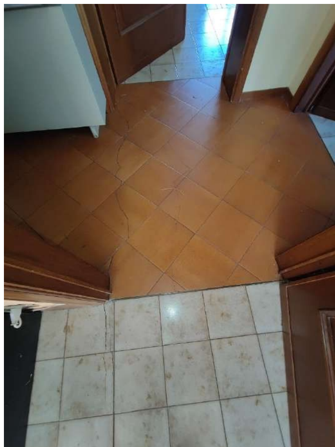
FOTO 16: lesione pavimento camere/disimpegno
