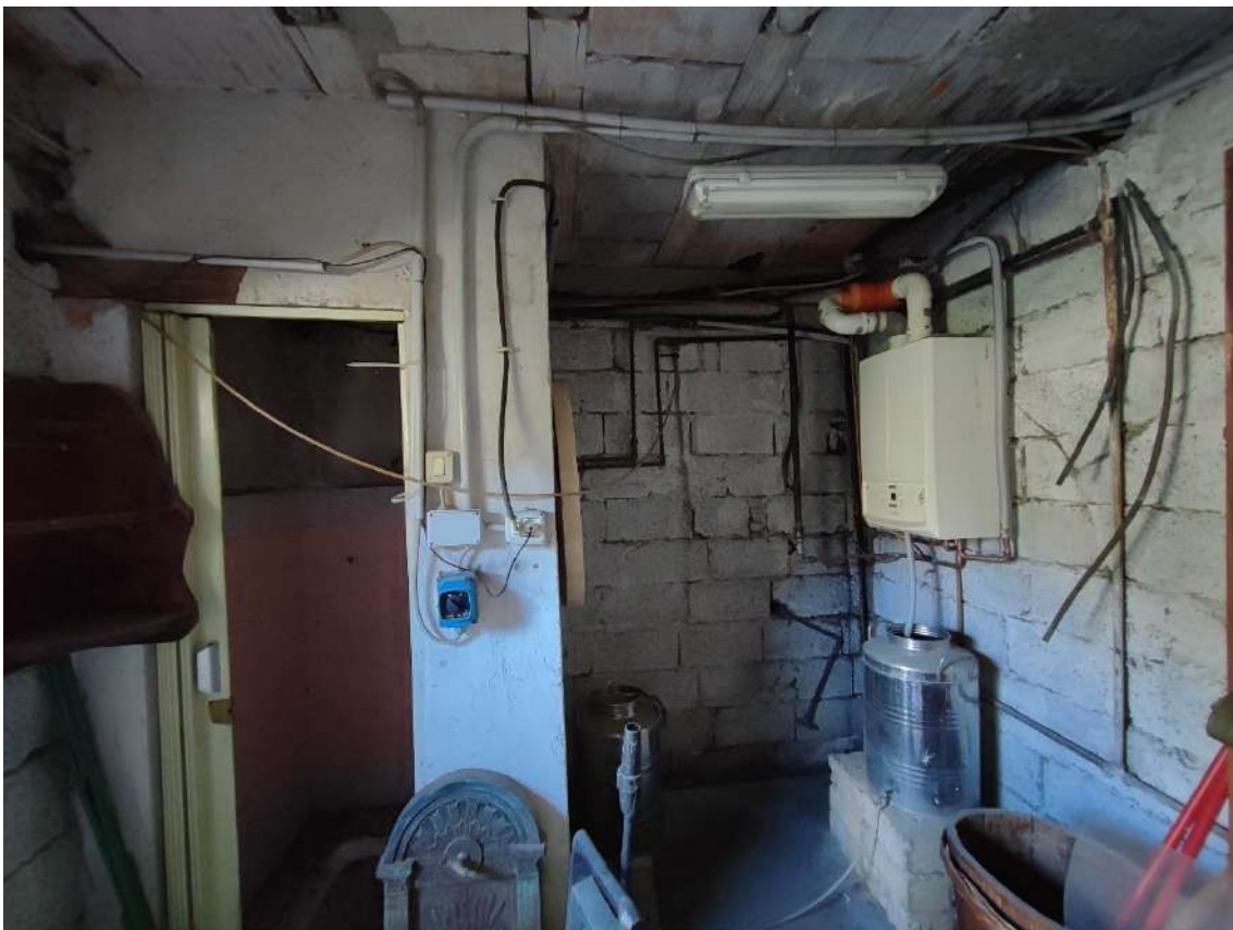
FOTO 20: Vano caldaia a piano seminterrato
