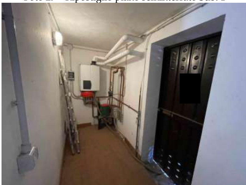
Foto 30 - Locaie tecnico centrale termica piano seminterrato Sub. 1
