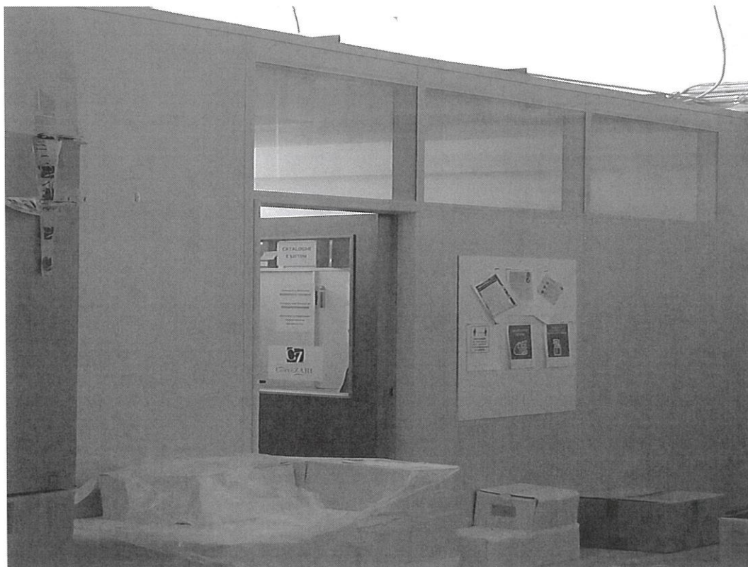
SECONDA STRUTTURA ADIBITA A UFFICIO DA SANARE O DA RIMUOVERE
