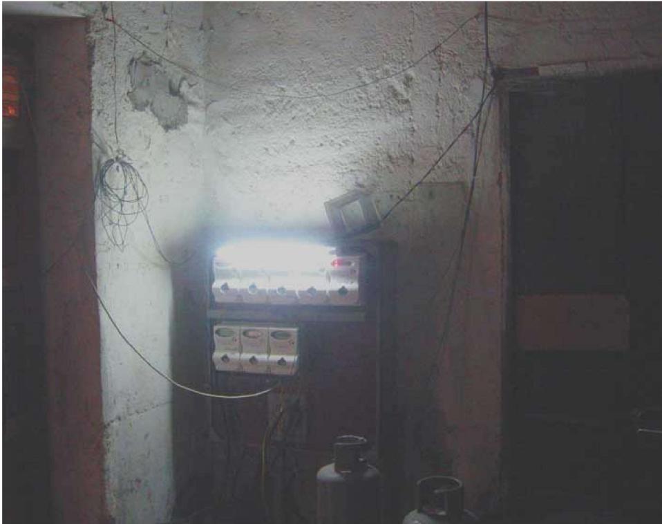
Foto N° 3 Unità immobiliare in Via Nazionale– Fl 13 part.IIa 223 sub 4 – particolare contatore
