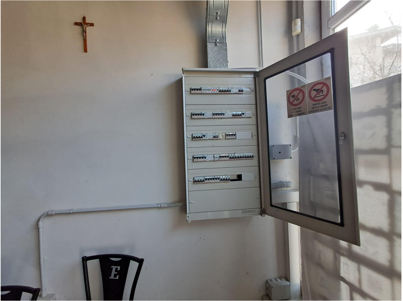
Foto 7: PART.LLA 292 QADRO ELETTRICO.
