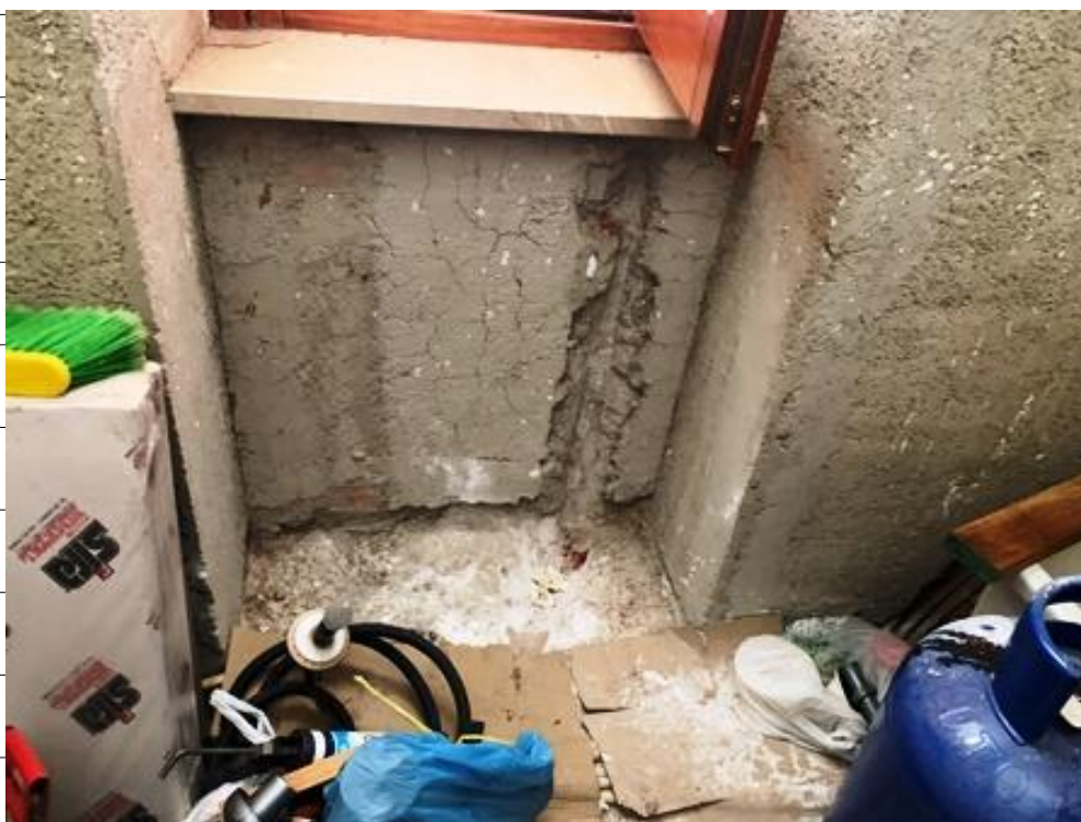
Il Vano wc si presenta allo stato rustico ed incompleto
