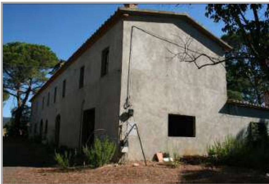
Foto “ 44 ” – Vista degli immobili F. 13 Part 16 Sub.4 e 5 in corso di costruzione
