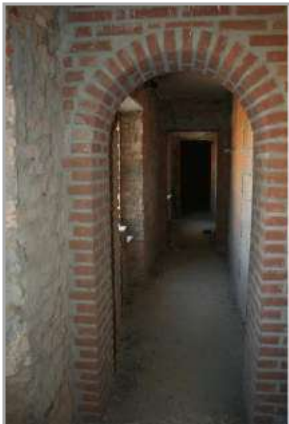
Foto " 50 " – Vista degli interni immobili F. 13 Part 16 Sub.4 e 5 in corso di costruzione
