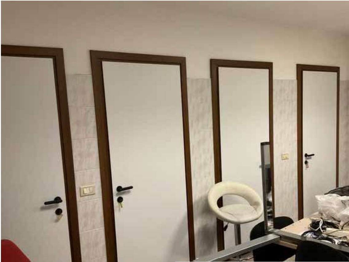
foto 67 - vista servizi zona magazzino LOTTO 3
