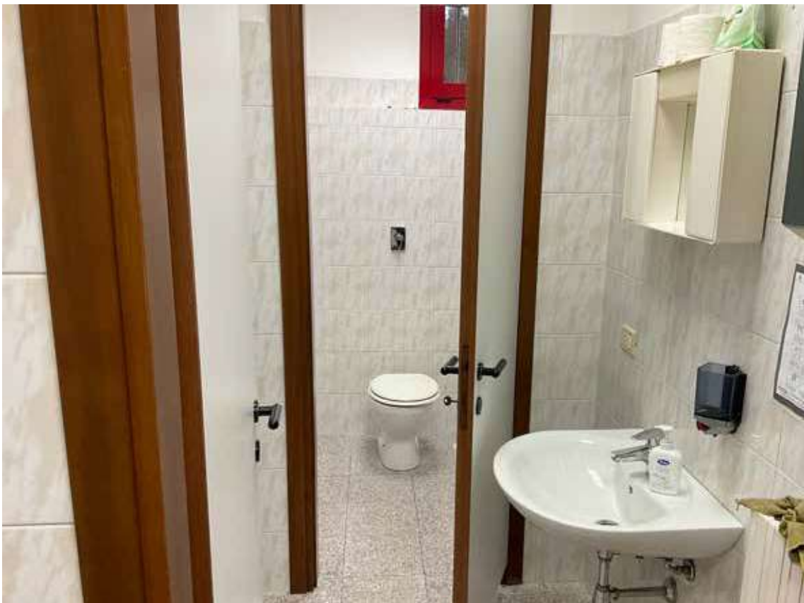
foto 68 - vista servizi zona magazzino LOTTO 3
