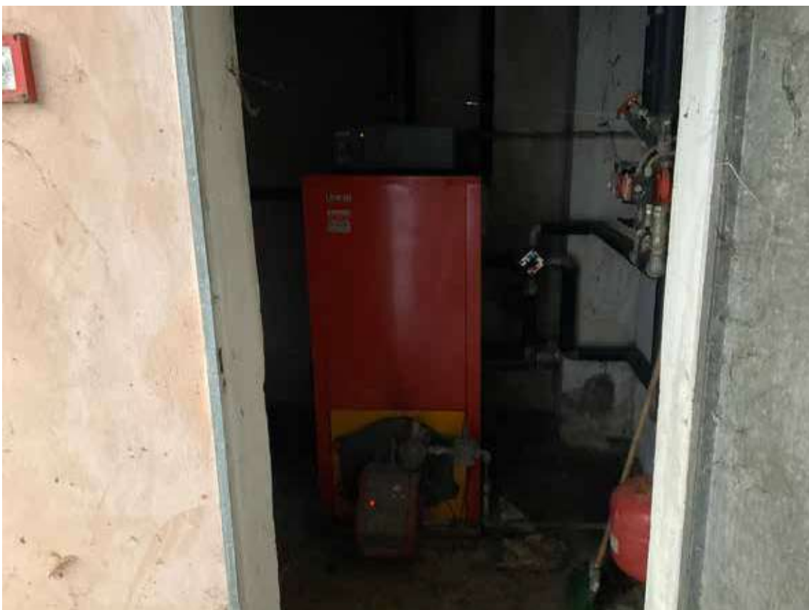
foto 22 - vista centrale termica LOTTO 1
