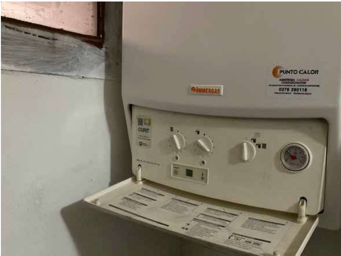
foto 85 - vista caldaia LOTTO 4
