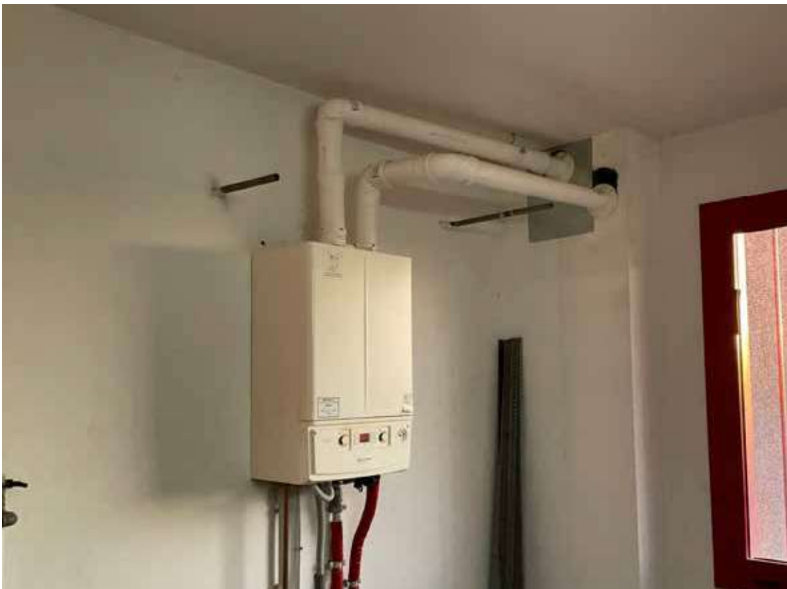
foto 56 - vista centrale termica LOTTO 3
