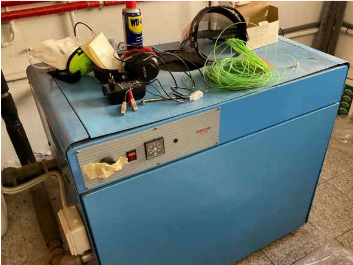
foto 57 - vista centrale termica LOTTO 3
