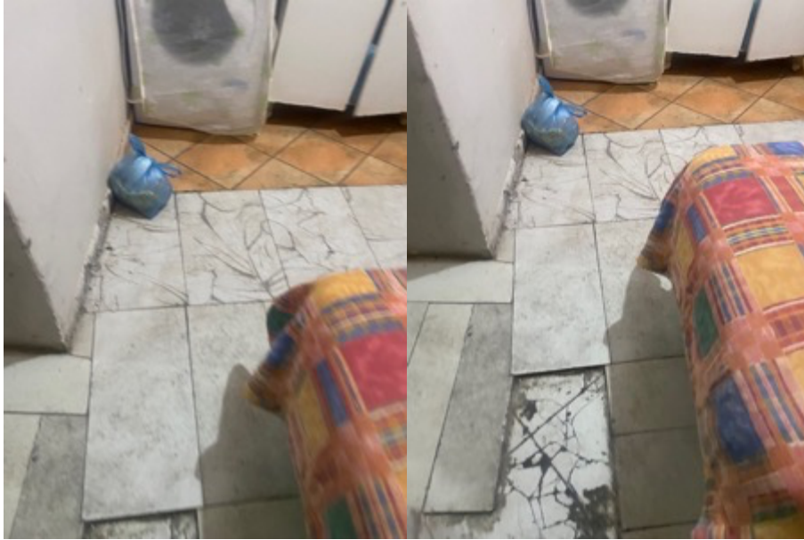
Foto da 11 a 12: Vista pavimento divelto e lesionato
