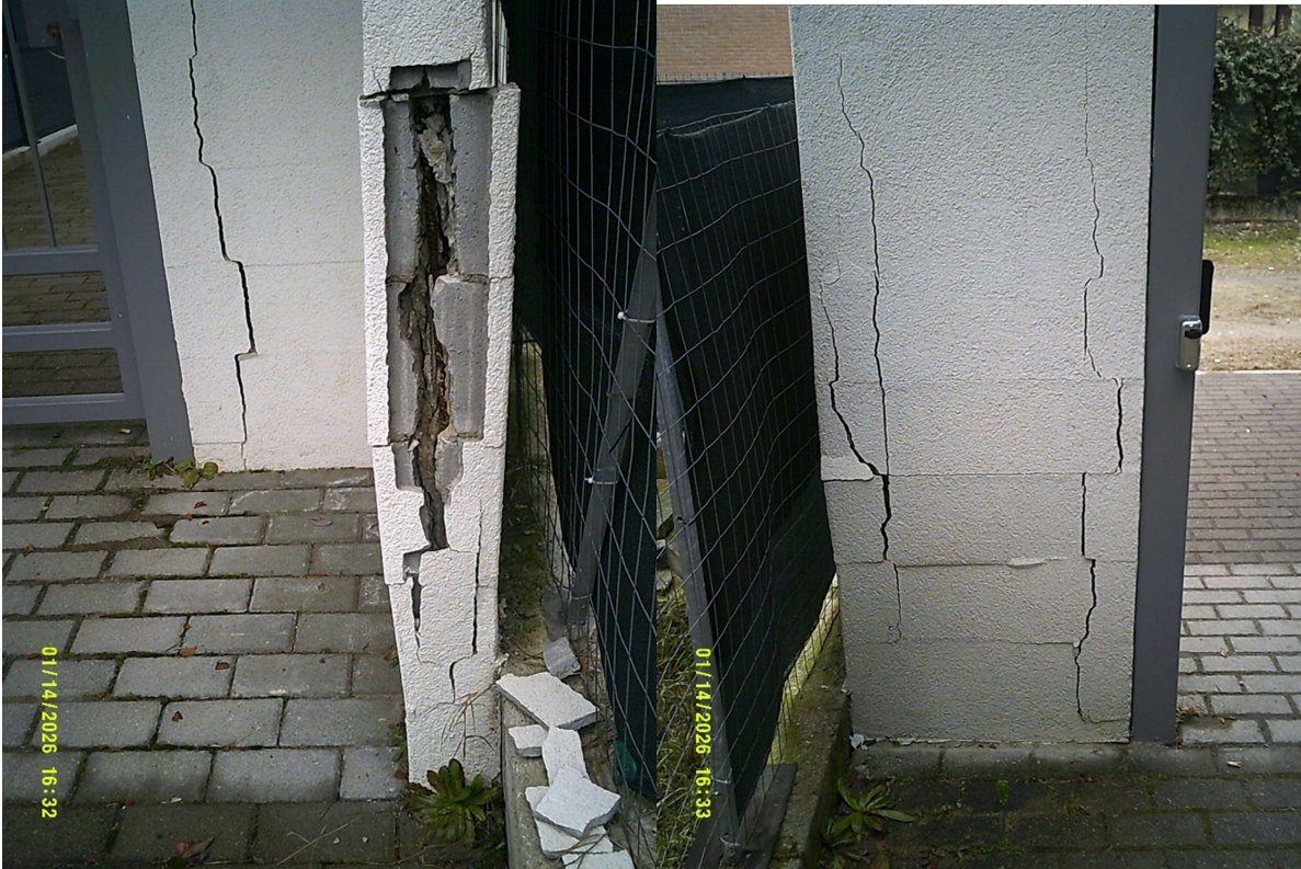
Cedimento strutturale della muratura del Cancellò d'ingresso in condizioni critiche , con pericolo di crollo dell'intera struttura – rilevata dal sopralluogo in data 14-01-26
