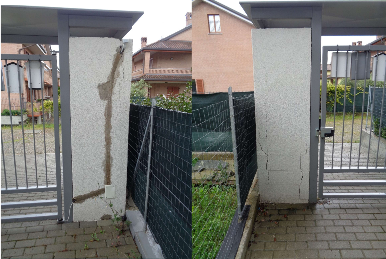
Situazione strutturale del Cancellò d'ingresso precaria , rilevata dal sopralluogo in data 02-05-24
