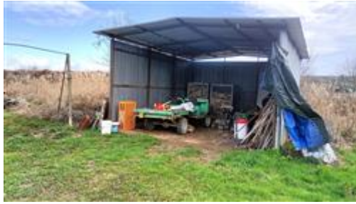
Rimessa attrezzi F2 non autorizzata
