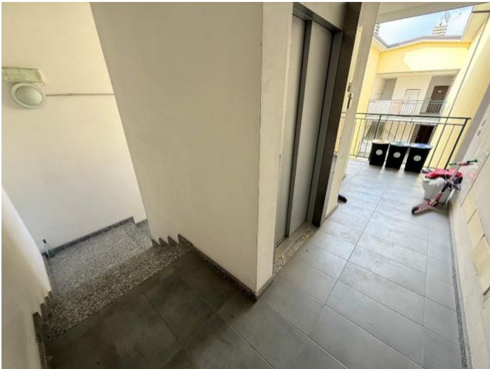
Fabbricato - Scala A - Vano scala - Da Piano Primo a Piano Secondo (foto 4)
