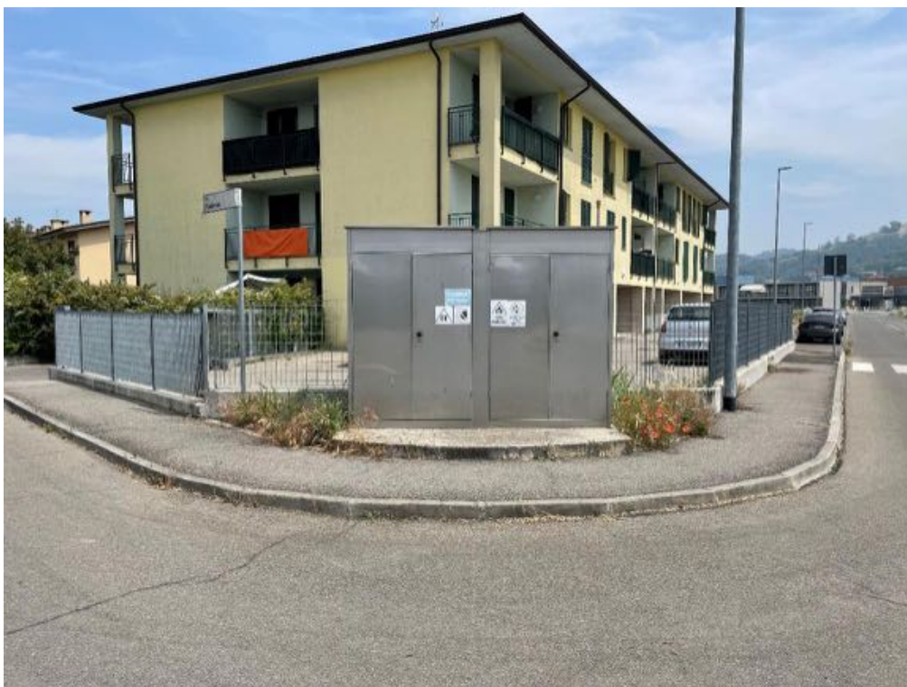
Via Padania - Part. 2002 - Unità tecnologica cabina metano (foto 2)
