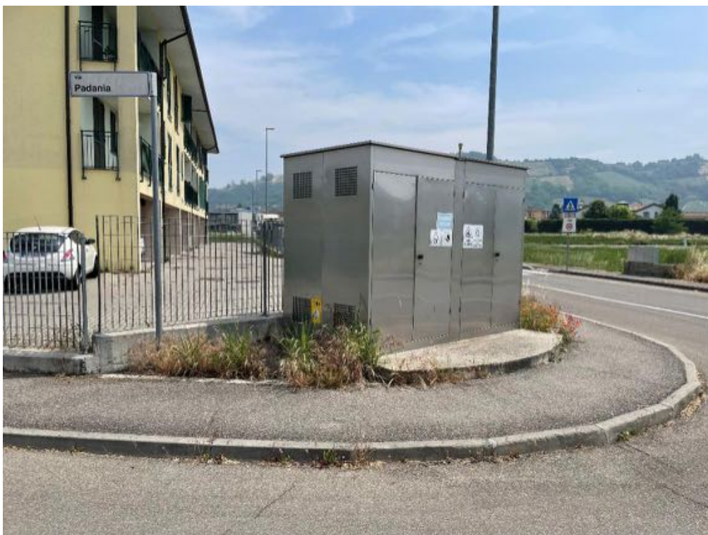
Via Padania - Part. 2002 - Unità tecnologica cabina metano (foto 1)
