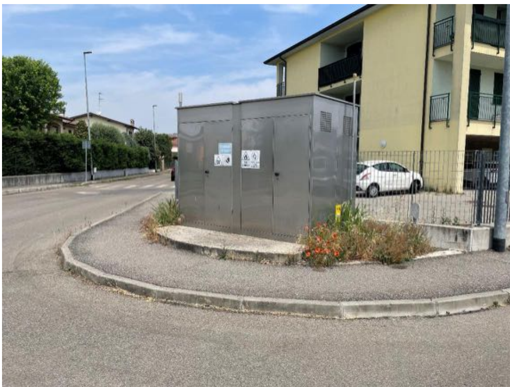
Via Padania - Part. 2002 - Unità tecnologica cabina metano (foto 3)
