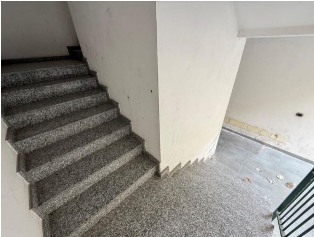
Fabbricato - Scala B - Vano scala - Da Piano Terra a Piano Primo (foto 2)
