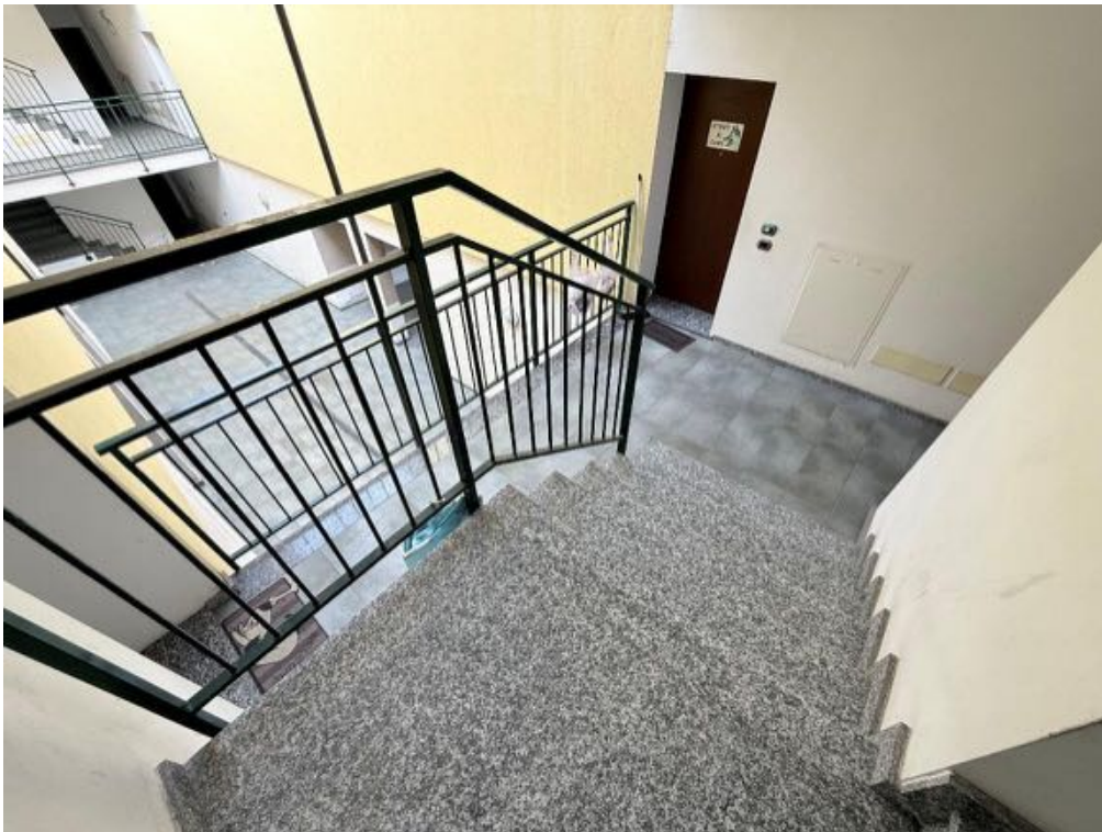
Fabbricato - Scala A - Vano scala - Da Piano Primo a Piano Secondo (foto 2)
