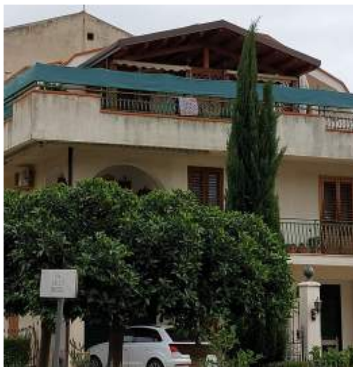
Foto 4° - Particolare della tettoia al Secondo Piano sul fronte principale dello stabile su via Guarnaccia 51, Pietraperzia.
