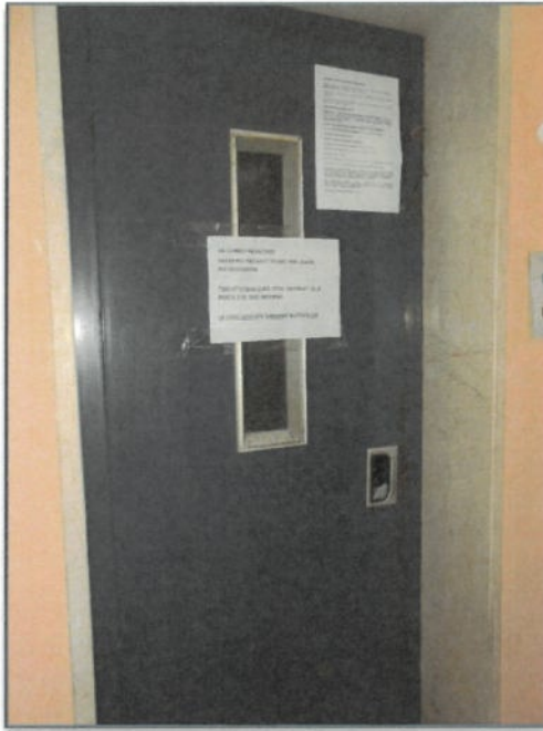
Foto 5 ascensore non funzionante
