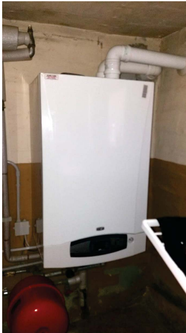
Figura 8 –PIANO SOTTOSTRADA – CALDAIA PER INTERO EDIFICIO
