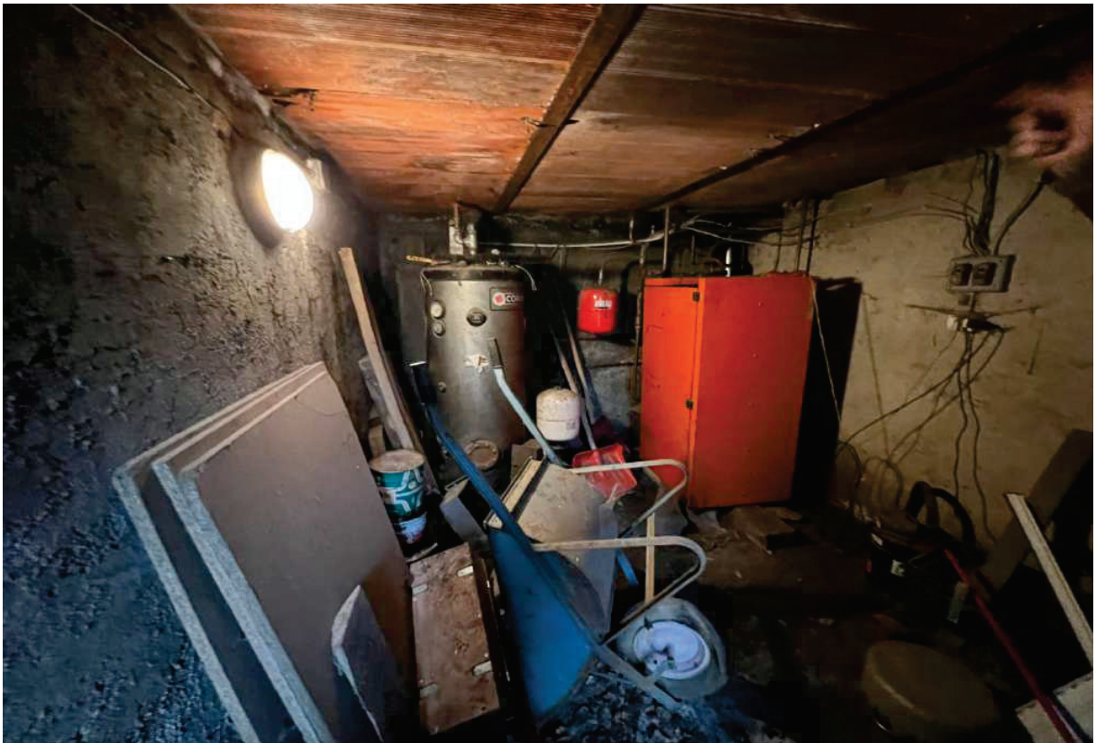
FOTO 16: Veduta interna lotto 2 corpo A: locale C.T.
