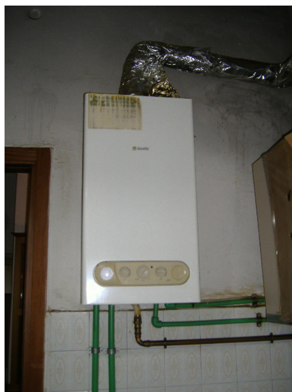
Cucina (generatore per riscaldamento e ACS)
