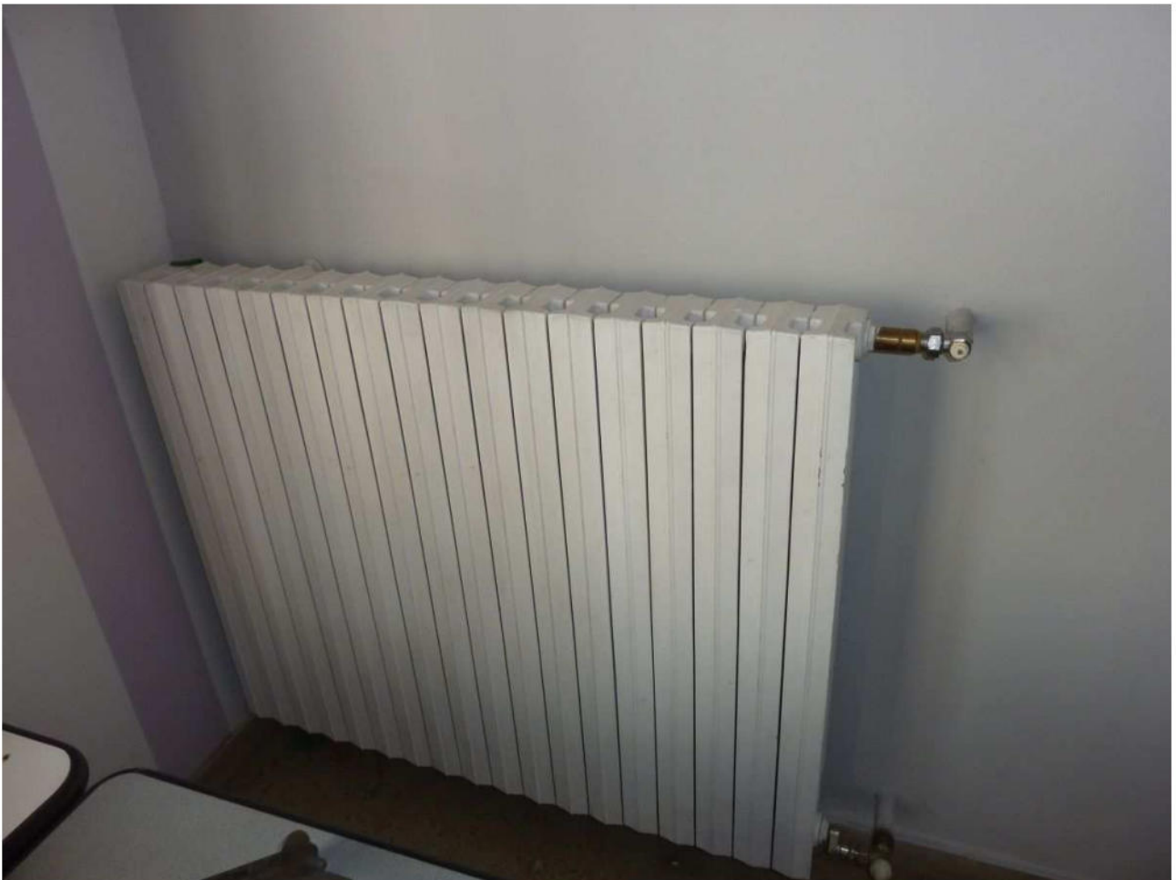
23. Particolare di un termosifone del locale ristorante
