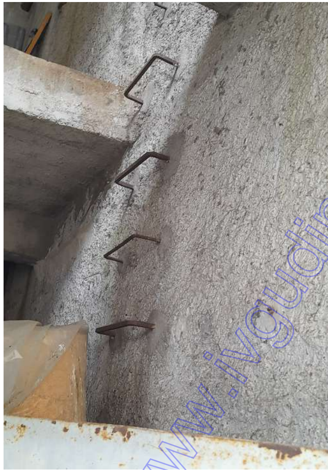
“scala” arrugginita di accesso al 1° piano ex fienile
