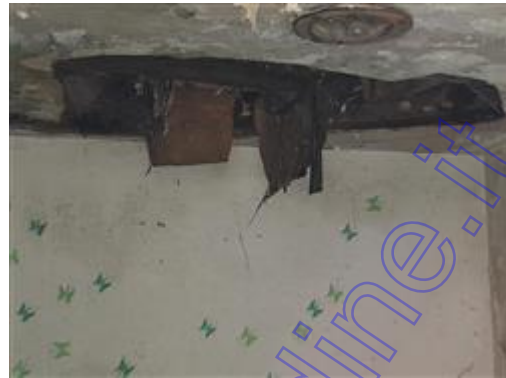
Particolare del solaio crollato in sala da pranzo
