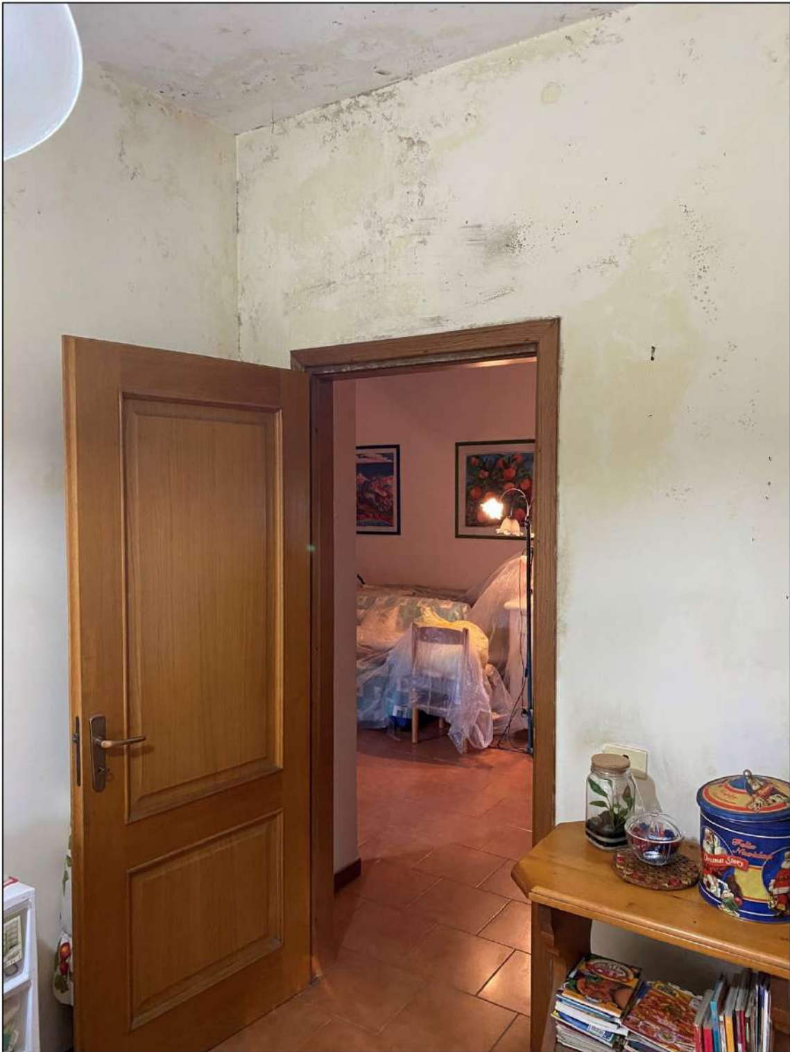
FIGURA 15. PARTICOLARE AMMALORAMENTI PARETI E SOFFITTI.
