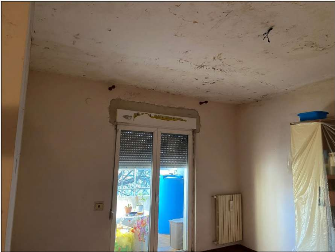
FIGURA 11. PARTICOLARE AMMALORAMENTI PARETI E SOFFITTI.
