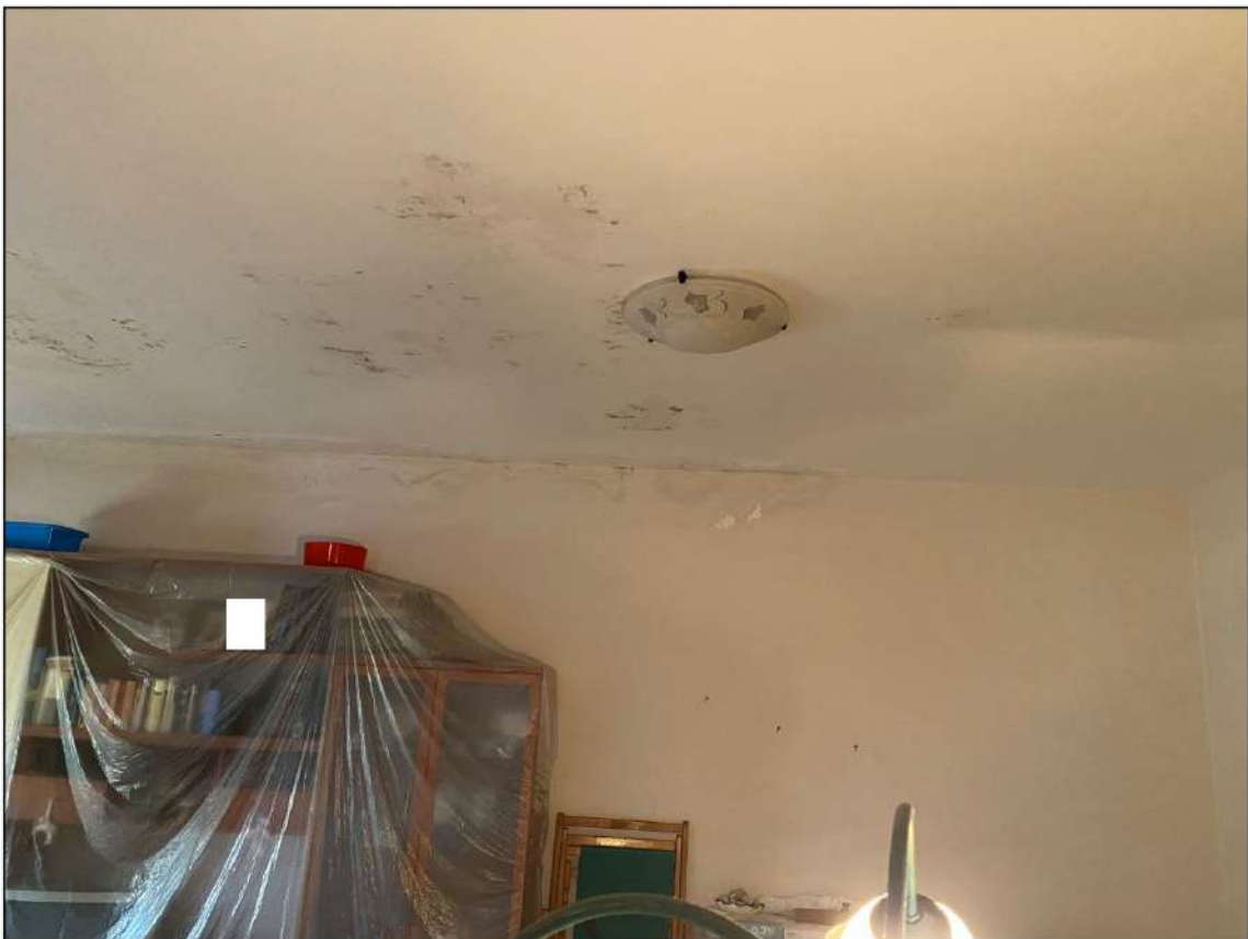
FIGURA 12. PARTICOLARE AMMALORAMENTI PARETI E SOFFITTI.
