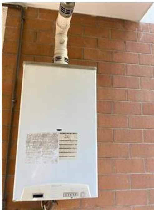
Esterno dell'appartamento oggetto di esecuzione (sub.53), particolare caldaia del 2004 posizionata all'esterno ed alimentata a metano.
