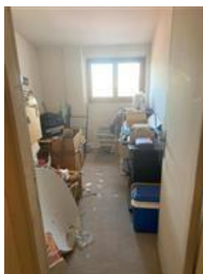
Stato di fatto della Soffitta contraddistinta al Subalterno 73 con una unica finestra realizzata.
