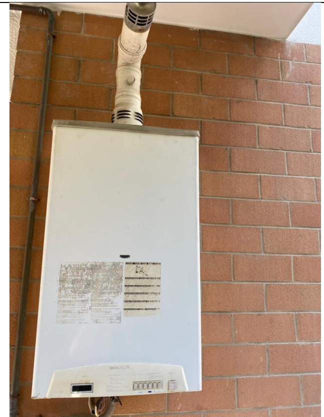
Esterno appartamento_ particolare caldaia del 2004.
