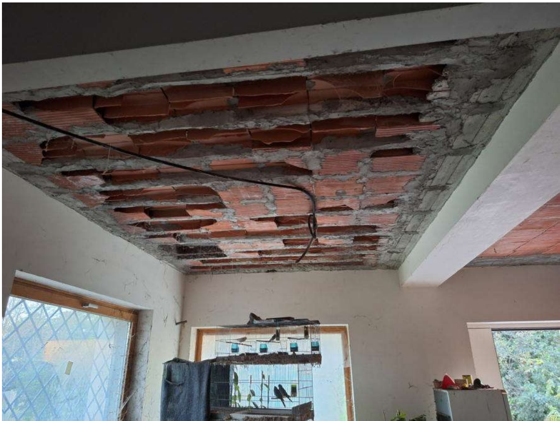
Foto 28 – Particolare stato di degrado solaio locale vasca
