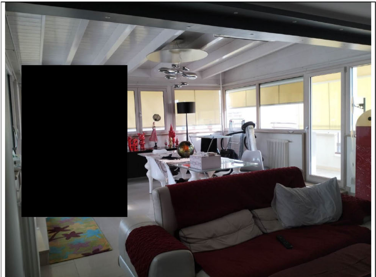
3 – Salone creato abusivamente con la chiusura della tettoia, non sanabile
