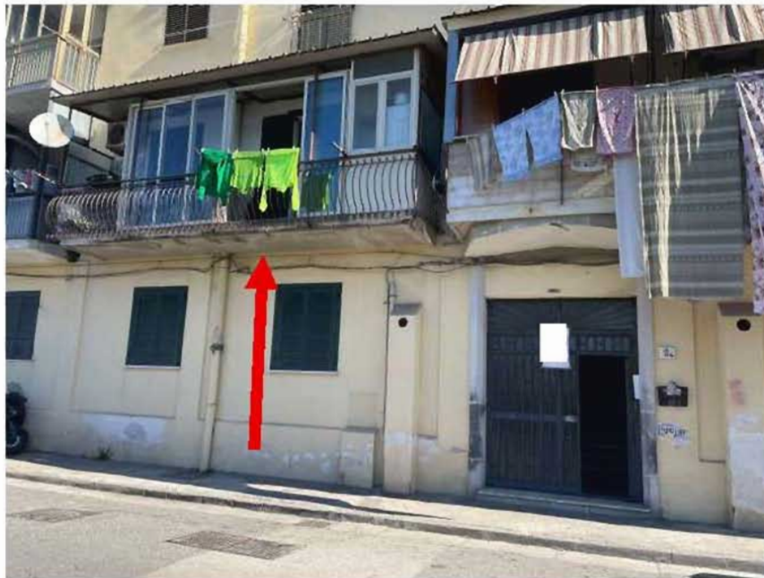
Foto n. 2: • Il balcone indicato appartiene all'immobile pignorato (il portone fronte strada è il civico 12). • Si noti la struttura tipo veranda. • Poggiolo abusivo da rimuovere.
