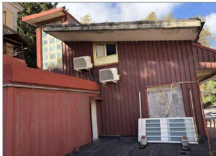
Foto nn.12-13-14-15-16: La diversa esecuzione della copertura con una quota di impostazione totalmente diversa da quella autorizzata.
