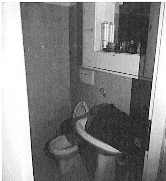
Figura 21 – Vista locale bagno piano interrato
