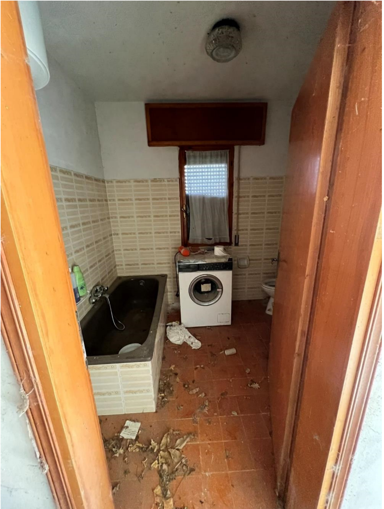
Fot. 16 – Vista del servizio igienico ubicato al piano primo, scollegato dalle camere da letto.
