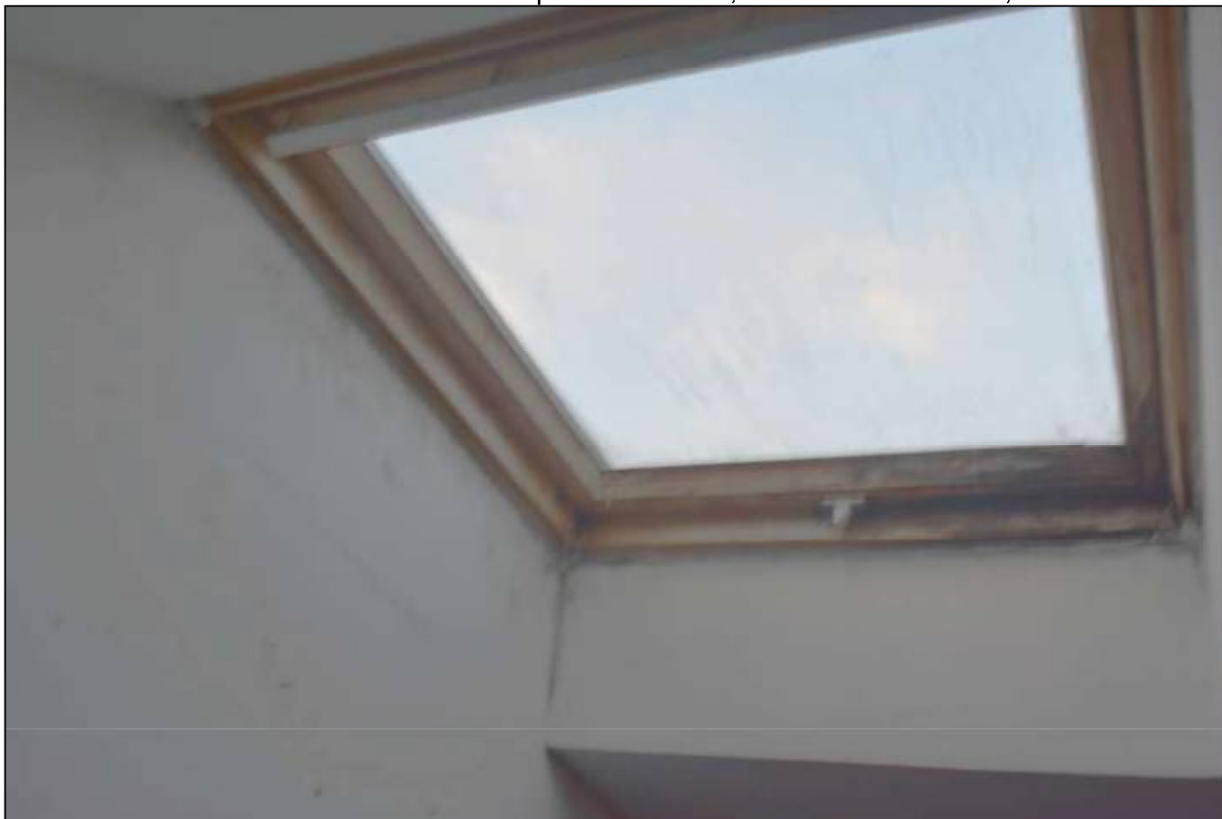
Foto N. 03: Lucernario nella camera 2 del piano sottotetto, a sinistra di chi entra, ove sono stati
